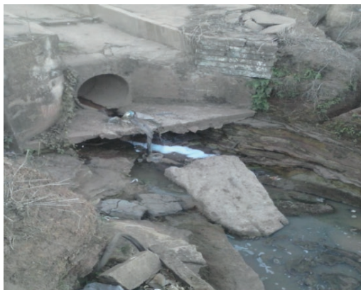
Figura 2: Esgoto da Santa Luzia, bairro de Jaciara-MT.
